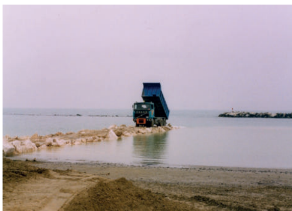
Figura 17. Varie lavorazioni di salpamento e ricarica scogliere durante l'intervento di riqualificazione funzionale delle opere di difesa della costa, in località Igea marina
